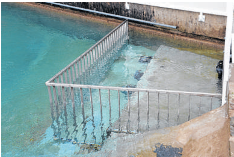
Das einfließende Wasser rotiert im gesamten Becken. Daher ist der Absaug- und Einlassbereich auch massiv vergittert.
