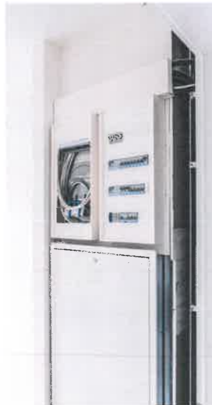
Das gesamte Warm- und Kaltwasser wird in diesem Teil des „Technikschrankes“ über einfache Ventile geregelt.
