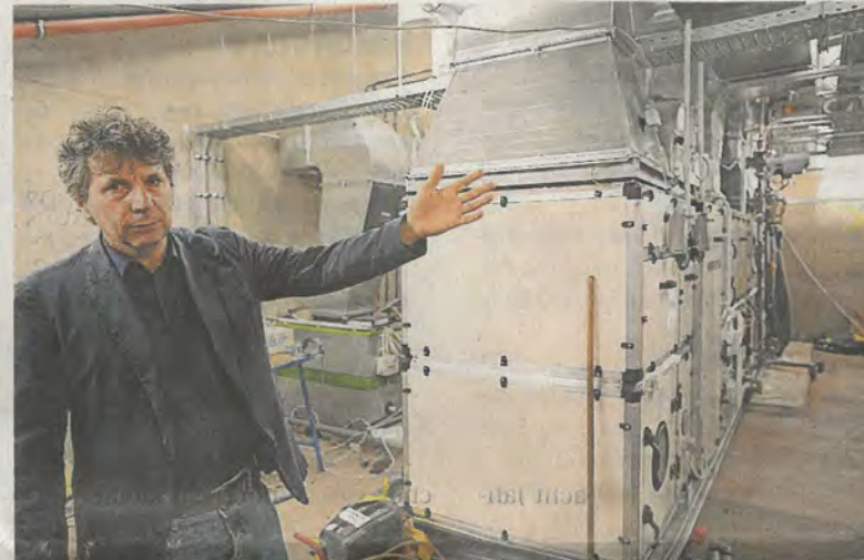
Modernste Klimatechnik: Jörn Kaluza vom Ingenieurbüro Inco kennt alle Details der nagelneuen Anlagen, die bei den Präsentationen für optimale atmosphärische Bedingungen sorgen.
