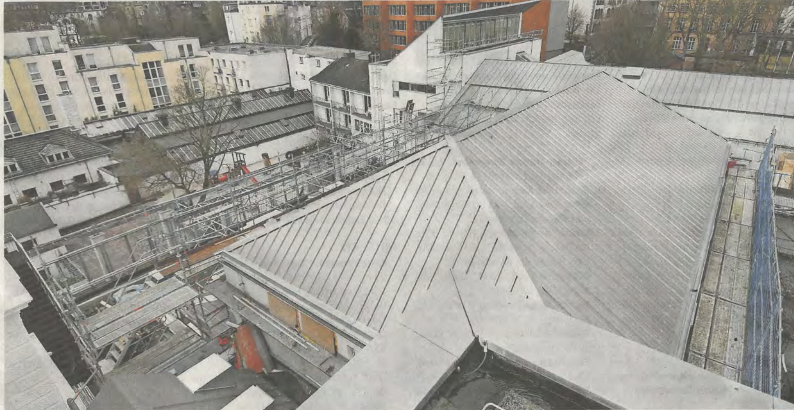
Bestens behütet: Das Dach am Anbau des Suermondt-Ludwig-Museums ist inzwischen komplett erneuert worden, um optimale Klimatisierung zu gewährleisten.
